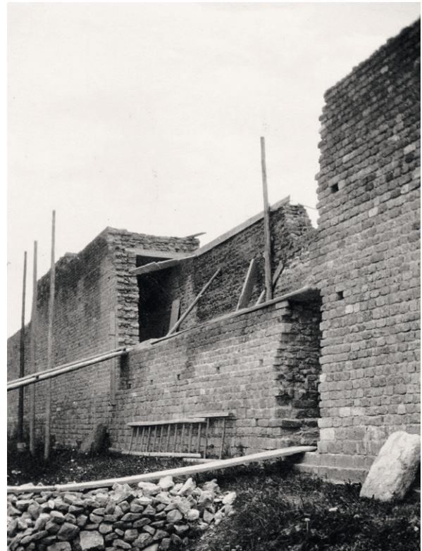
619 Restaurierungen am Teilstück T1-T2_M1. Auf den bestehenden, originalen Mauerkern werden nach dem «System Siegwart» zwei Mauerschalen mit einer abschliessenden Betonplatten-Abdeckung aufgebaut (11.8.1917). Vgl. Abb. 45.
