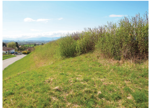
905 Aktuelle Situation extra muros im Bereich von T44. Die 1907 restaurierten Mauerpartien sind vollständig überwachsen und nicht mehr sichtbar (2014).
