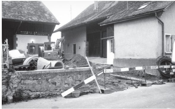
931 Ausgrabungssituation im Bereich des Teilstückes T55–T56_M1. Der Aufschluss der Kurtine befand sich unmittelbar an der Hausfassade, rechts im Bild (Ausgrabung 1999.06).
