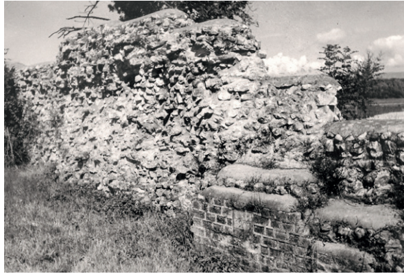
697 Blick auf die 1902 restaurierte Mauerpartie von La Maladaire (T8–T9_M1). Die Zementdeckel, mit denen der originale Mauerkern gedeckt wurden, sind randlich von Bewuchs aufgebrochen und lösen sich vom Trägermauerwerk (Zustand 1960, vgl. Abb. 30 mit dem Zustand um 1902).
