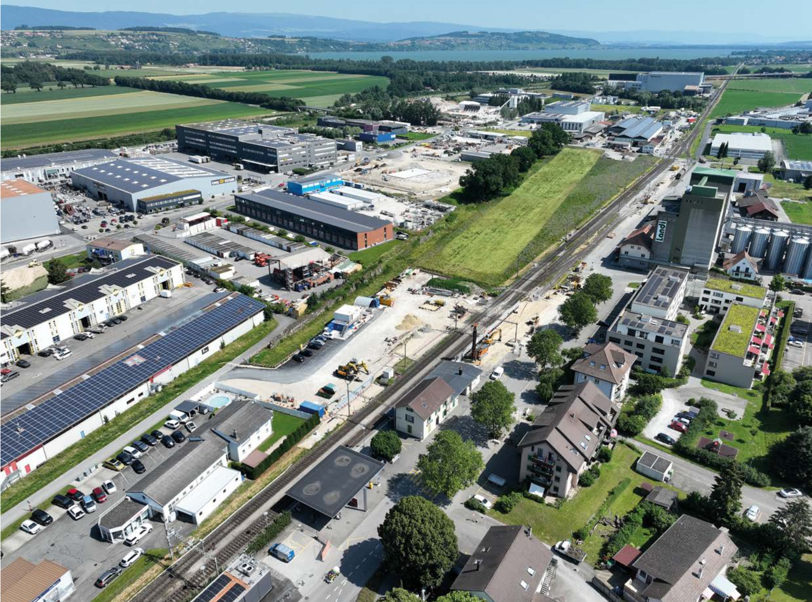
Vue aérienne des travaux effectués sur les voies et vers la gare d'Avenches (au premier plan) entre les passages à niveau de la Zone sportive et de la route de l'Estivage. La parcelle entre la gare et la muraille a été réaménagée temporairement en place de chantier.
